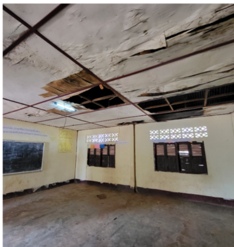
Dringend nötig erscheint eine Sanierung der einsturzgefährdeten und deshalb aktuell geschlossenen Schulanlage in Ban Lhak Song in einem Vorort der Provinzhauptstadt Salavan.
